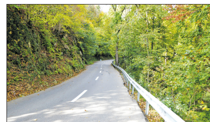
Staffelegg in Richtung Thalheim wird auf der linken Strassenseite ein Betonrigel mit Verankerung in den Felsen erstellt. Dieser soll die zukünftige Strasse an Ort halten. Dasselbe ist auch im Waldstück Brändisried geplant, wo heute die Bewegung des Untergrunds sichtbar sind.
