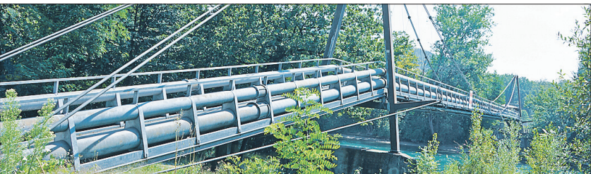
Brugg schaut zu seinen Brücken – auch zu der 40-jährigen Rohrhängebrücke Aufeld, die für fast 0,55 Mio. Fr. saniert werden soll.
