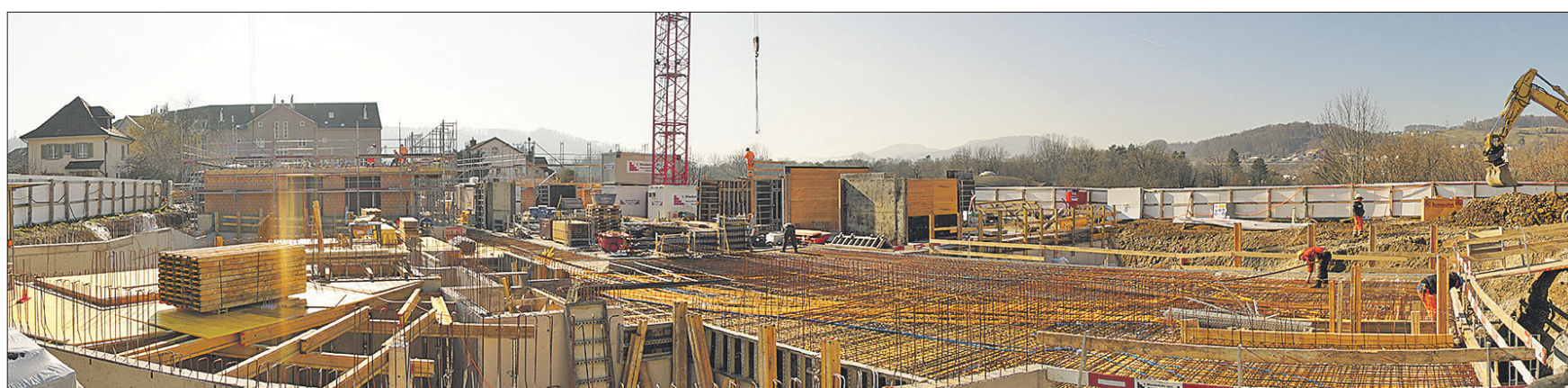
Oben der gegenwärtige Stand der Dinge: Es werden gerade die Erdgeschosse errichtet.
