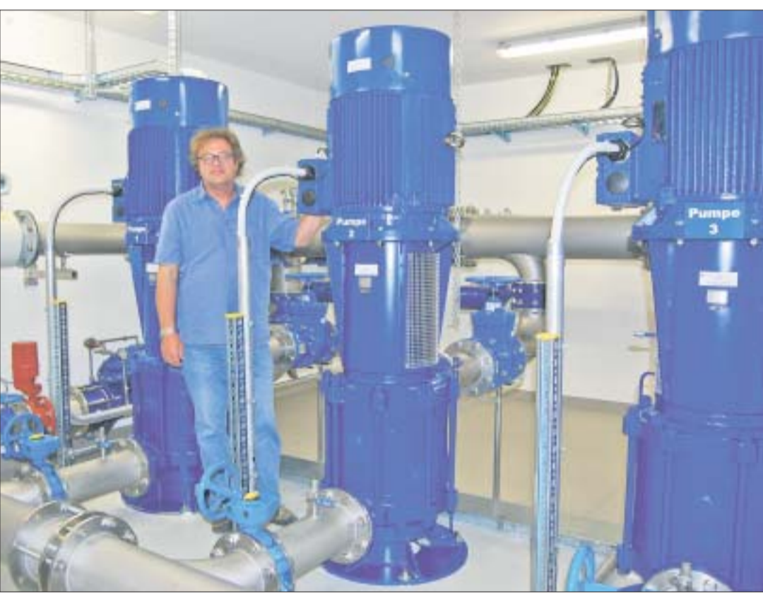
2'500 Liter Wasser pro Minute vermag jede einzelne Pumpe zu fördern: Remy Schärer freut sich über das gelungene Werk mit dem neuen Stufenpumpwerk der REWA
