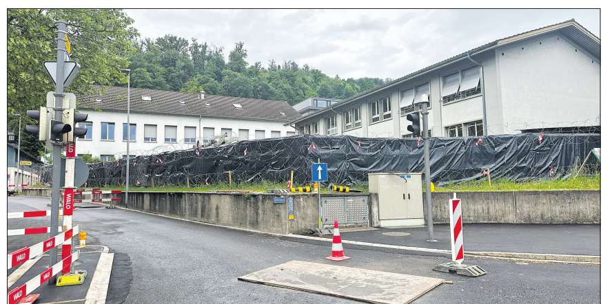
Mit der Kaserne zeigt sich auch der «bruggereisenfisch» verhüllt (Brugg verfügt als eine der wenigen Städte über drei Luginbühl-Plastiken, wobei alle ein bisschen versteckt sind – so wie die «Brugger Säule» beim Knoten Neumarkt und die Luginbühl-Bar im «Magma» im Bad Schinznach).
