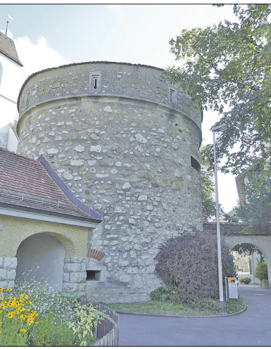
Der so genannte Archivturm, angebaut an die Stadtkirche, soll sehr schlecht beieinander sein. Das Gemäuer der 1558-1564 erstellten Wehrbaute ist renovationsbedürftig.
