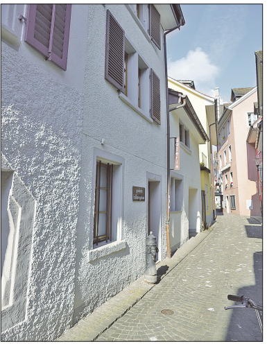
In sehr schlechtem Zustand: Die «Galerie Falkengasse», die gegen aussen zwar hübsch verputzt eine gute Falle macht, innen aber grösseres Renovationspotenzial aufweist.
