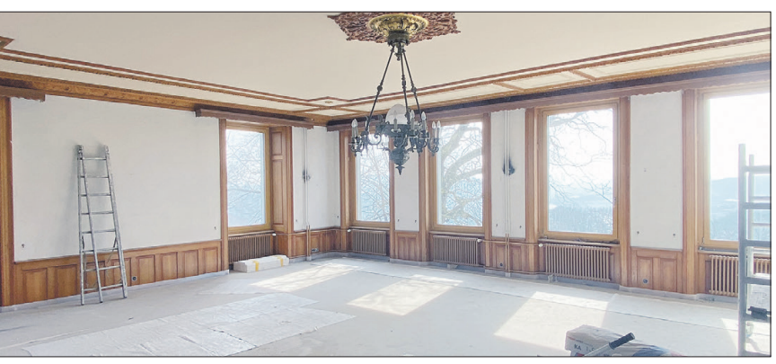
Aus dem ehemaligen Vierlinden-Saal entsteht derzeit eine tolle Loft-Wohnung, welche ab Juni vermietet werden soll.
