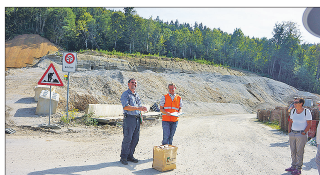
Hinter der Trasse der Südwestumfahrung die inzwischen abgebaute Waldnase. Davor Markus Ottiger und Baustellenleiter Marcel Voser, der als Geschenk einen speziellen Forstamtsack mit Cheminéeholz erhielt.
