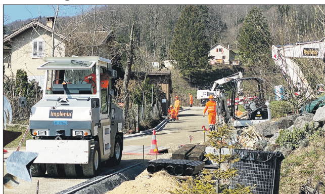
Der alte Bahn-Tunnel bekommt eine neue Strassen-Zufahrt, wie das Bild vom Freitag zeigt.
