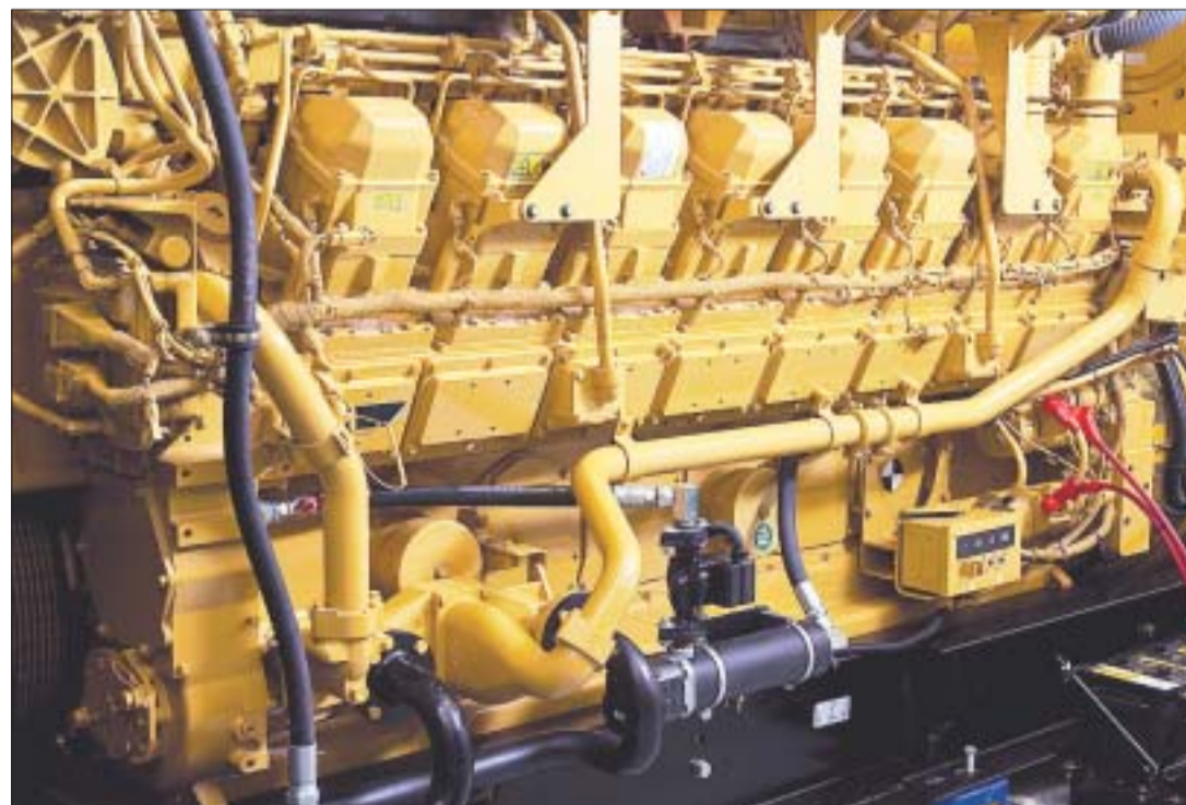
Zwei solche Diesel-Notstromgruppen stehen im Keller. Diese 16-Zylinder-Maschine hat 160 l Hubraum, leistet 3'000 PS und verbraucht 120 Liter Dieselöl pro Stunde. Zusammen mit einer Partie Batterien für die Überbrückung eines Spannungsabfalls sorgen die zwei Teile für Redundanz.
