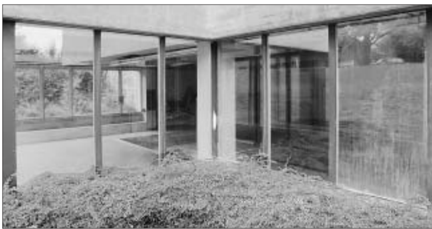
Fertig geschwommen: Das Lernschwimmbecken in der Bez Windisch wird zwar im Winter voll genutzt, ist aber mit seinen diversen baulichen und energetischen Mängeln in einem pitoyablen Zustand (Bild). Es soll rückgebaut werden - eine Sanierung will (und kann) sich Windisch nicht leisten.
