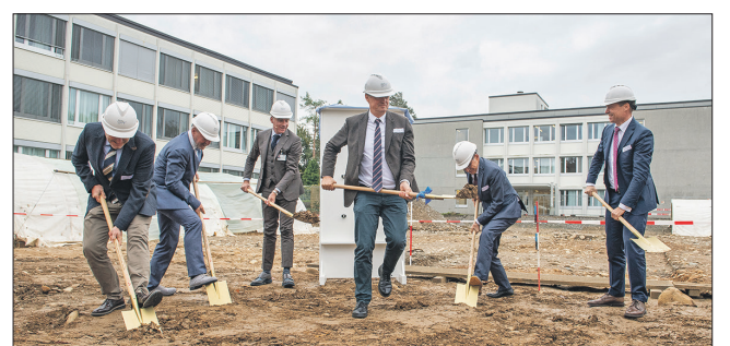
Peter Wermuth (Mitte vorne) darf den ersten Spatenstich machen. Beim Graben helfen (v. l.) Benjamin F. Brägger, Kurt Pfeuti, Jean-François Andrey, Landammann Urs Hofmann und Kurt Aeberhard. Hinten sind die Tunnel der Kantonsarchäologie zu sehen, unter denen sich römische Funde befinden: etwa Mauerreste eines Lagerspitals vor 2000 Jahren.
