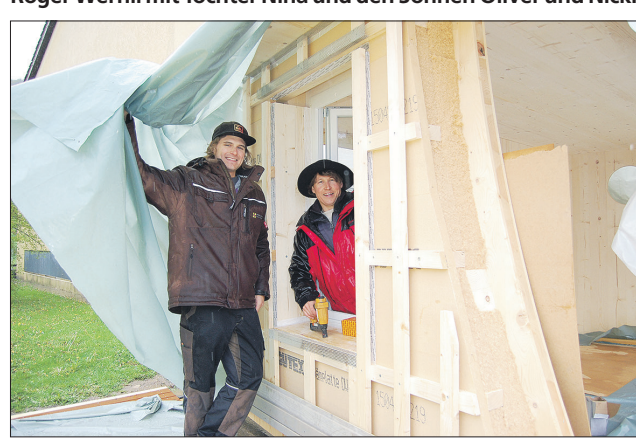
Fassadenaufbau zur Ansicht gezimmert: Fredy Müller (rechts) und Patrick Kury von Hinden Holzbau Remigen.
