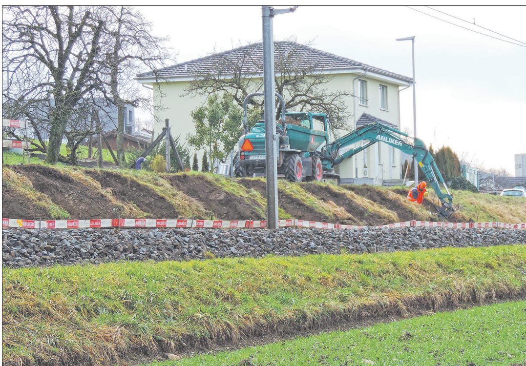
Ein Bagger beim Aushub für die Fundamente. Ab Fahrplanwechsel Dezember 2023 wird das neue Verkehrskonzept umgesetzt. Damit kann der Engpass Mägenwil-Ruppertswil entlastet werden, und die S11 fährt durchgehend im Halbstundentakt.
