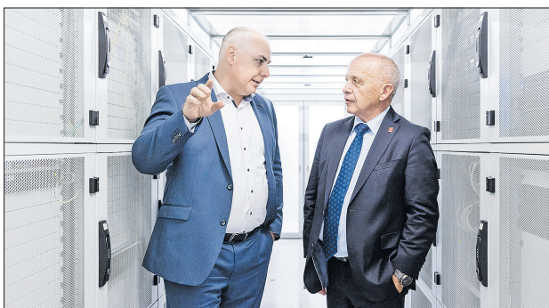
Roger Süess erläuterte Ueli Maurer unter anderem die aufwändige Notstromversorgung vom Green-Datacenter.
