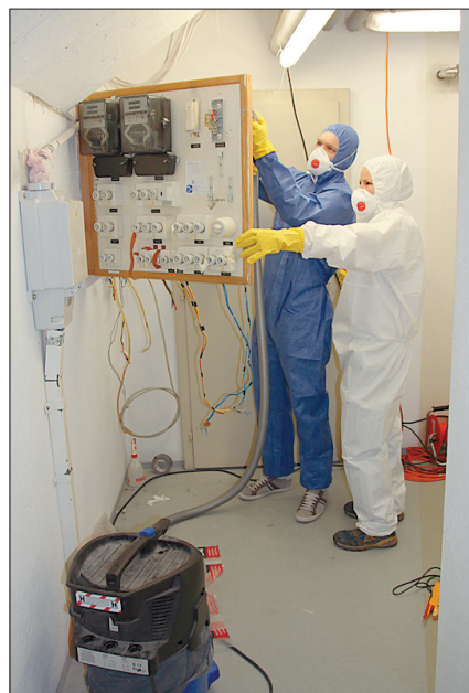
Bei Renovationen in älteren Häusern muss bei den Schalttafeln eine Asbestsanierung vorgenommen werden. Thut kanns.
