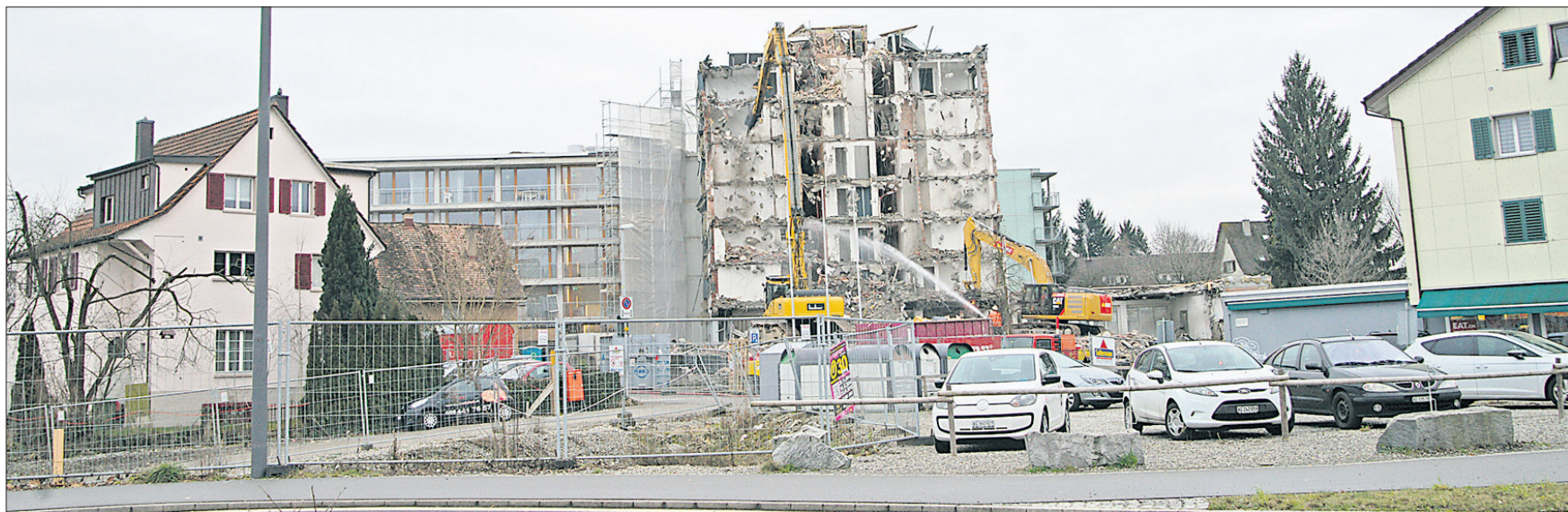
Blick aufs ganze Areal: In der Mitte die jetzt bereits weggeräumten Trümmer des Pflegezimmer-Altbaus. Links der Neubau, im Vordergrund das Gelände für den Neubau und rechts der Pizza-Laden.
