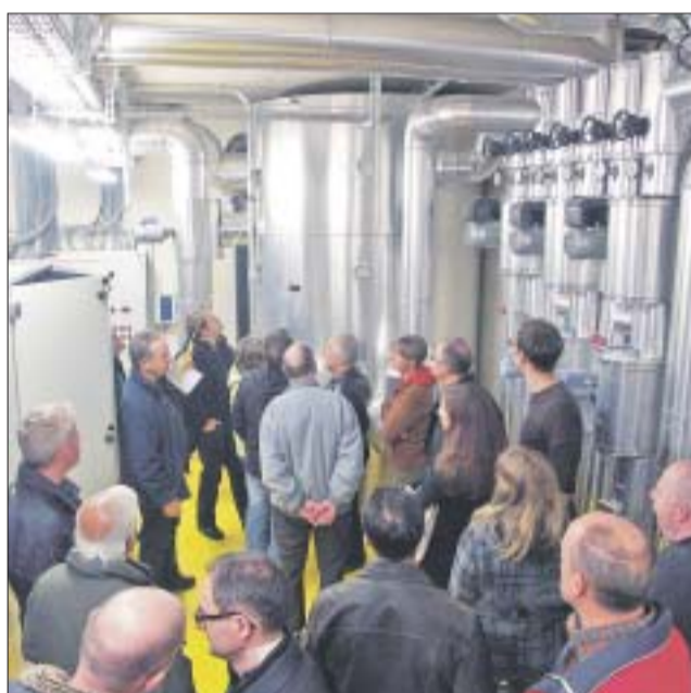
Vor allem Bewohnerinnen und Bewohner der Siedlung lassen sich über die Wärmepumpenanlage informieren.
