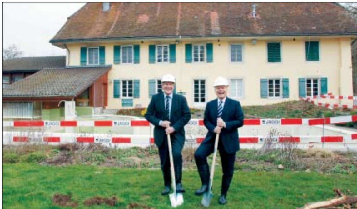
Hans-Rudolf Wyss (l.) und Daniel Bieri gutgelaunt am Ort des Geschehens. Unterdessen wurde schon zünftig Erdreich verschoben, und ein riesiger 55m-Kran zeugt schon von weitem von den begonnenen Bauarbeiten.
