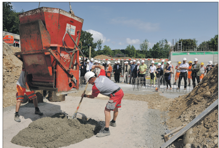
Es ist angerichtet: Der erste Beton für das Kinder- und Jugendpsychiatrische Zentrum der PDAG wurde vor viel Publikum gemischt und deckt den Grundstein. Bild: Palmo Fiacco / PDAG
