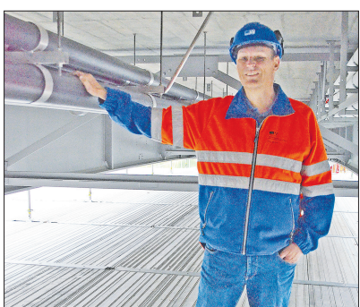
Projektleiter Peter Widmer zeigt unter der Brücke auf die Rohre mit den Telekommunikationskabeln.
