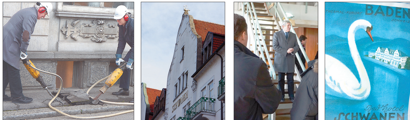
Mit den Pressluftschlämmern legen (l.) Hans-Rudolf Wyss (Brugger Immobilien AG) und Hans Setz (GU Gross AG, Brugg) Hand an den «Schwanen», dessen Fassade vom Fundament her ertüchtigt wird. Wyss bei der Begrüssung der 60 Spatenstich-Gäste. Und vielleicht wird ja ab 2017 wieder fürs Badhotel Schwanen geworben.
