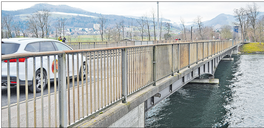
Die Aarebrücke in Richtung Schinznach-Dorf muss saniert und verstärkt werden.
