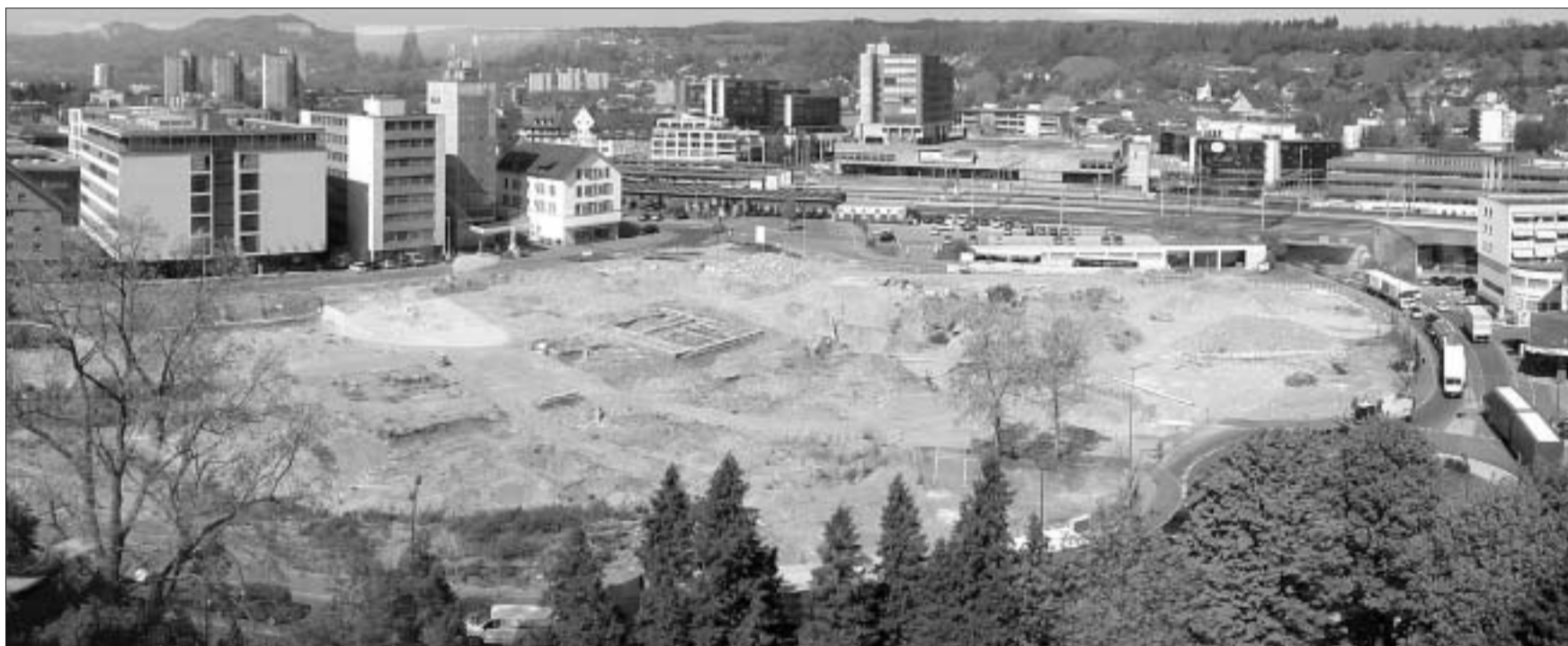
Hier entstehen die Fachhochschul-Neubauten des Campus-Brugg-Windisch – Baubeginn ist im Herbst 2010, der Bezug der Bauten soll 2013 erfolgen.
