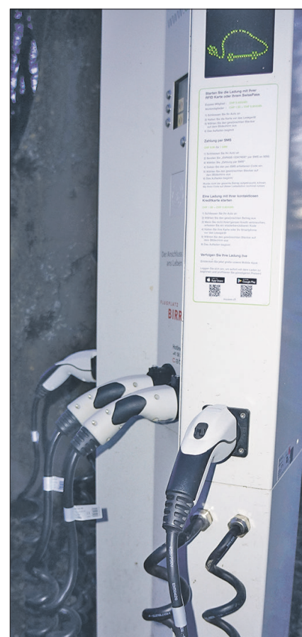
Vier Zapfsäulen stehen für die gängigen Ladeanschlüsse zur Verfügung.
